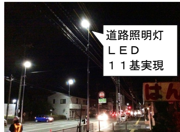
千鳥、花見地区に合計11基の道路照明灯
