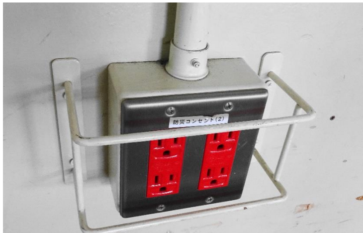
防災コンセント(体育館)
